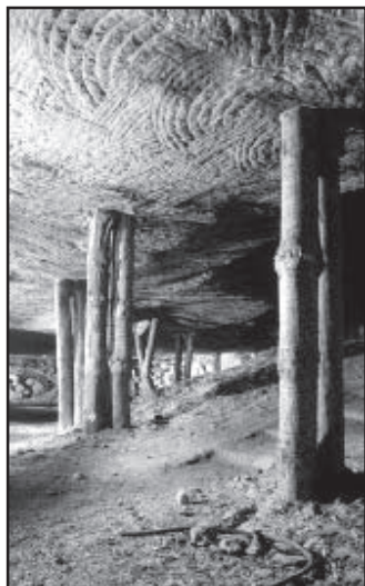
Кріплення камер за допомогою стояків
