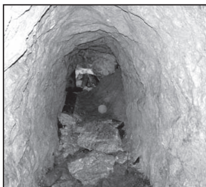
Обрушення порід покрівлі
